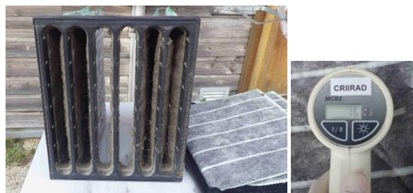
Filtres de centrale de traitement de l'air
