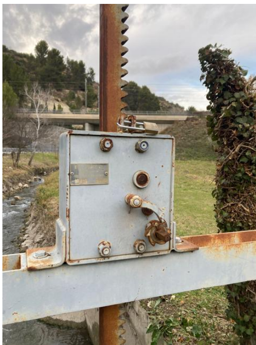
Photo 5 : la vanne gauche
